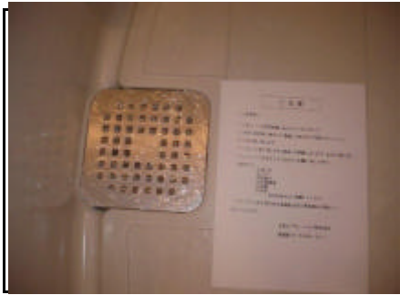
排水トラップ ラップ済み ラップに関する説明書設置済み
