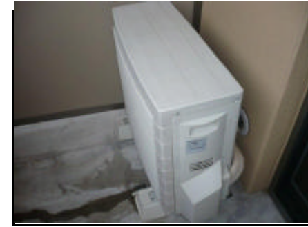
エアコン室外機
